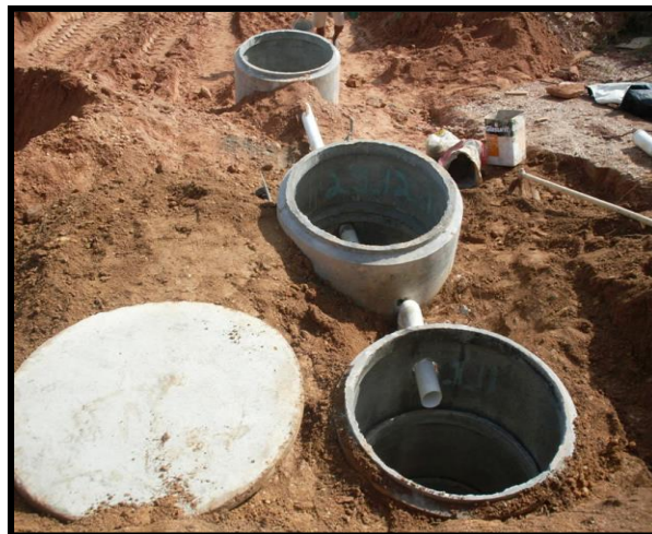
FOTO 02 – Fossa Séptica, filtro e sumidouro
